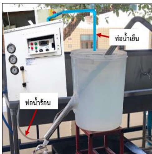
ภาพที่ 3-12 แสดงท่อน้ำเย็นและท่อน้ำร้อน
